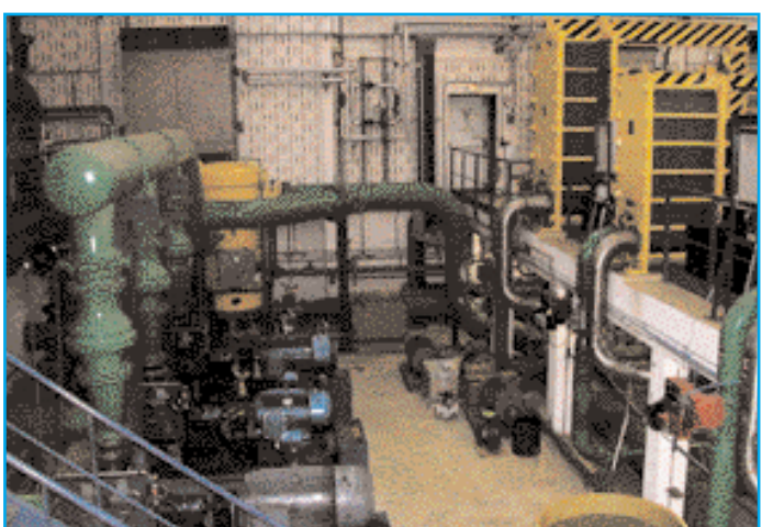
L'imposante station de pompage du circuit primaire envoie son eau refroidir celle du circuit secondaire.
