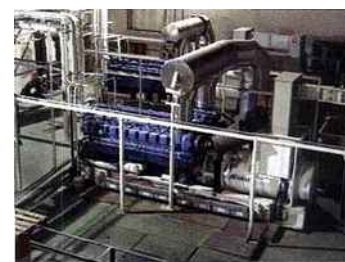
Centrale de secours
